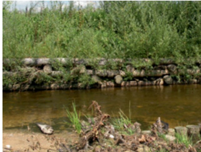
Krainerwände dienen als ingenieurb biologische Ufersicherungen.
