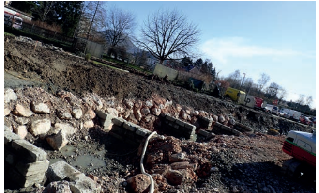
Abbildung 4.22: Einblick in die beinahe vollständige Fischauftiegshilfe.
