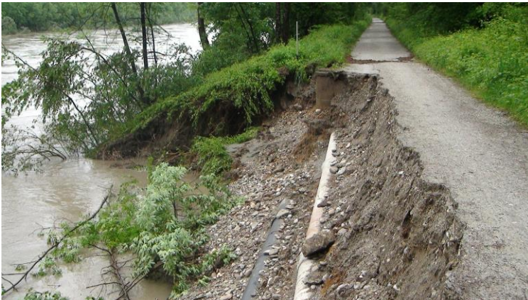
Eintiefung, unterspülte Ufer
