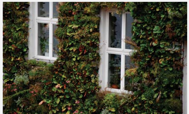
Wandgebundene teilflächige Fassadenbegrünung, Ort: Wien © GRÜNSTATTGRAU/Gruchmann
