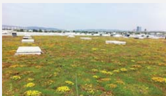
Extensivbegrünung, Ort: Wien © GRÜNSTATTGRAU
