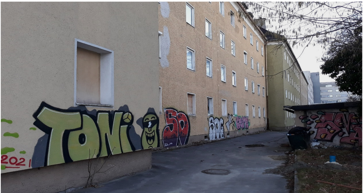
Abb. 1: Mehrjährig leerstehende, ehemalige ÖBB-Bauten in der Fanny-von-Lehnert-Straße, Ende 2022 im Abbruch (Foto: Nov. 2021)
